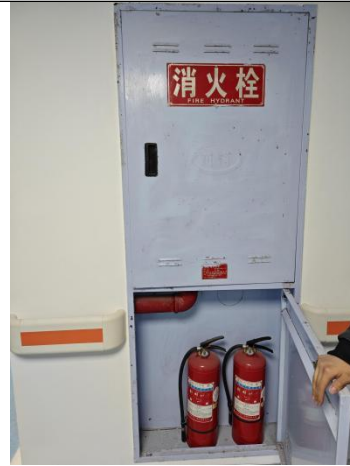
图3-10 现场消防设施图片
